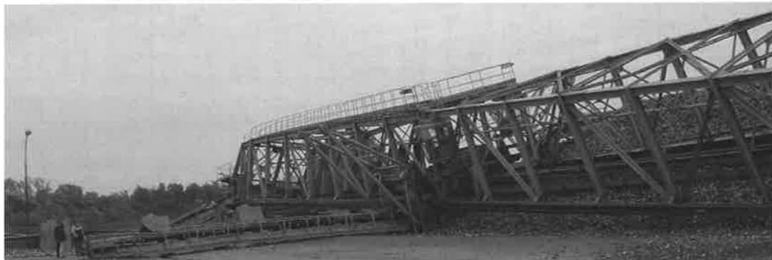
Slika 1. Nezgoda s kolapsom kovinske strukture portalnega žerjava
